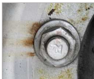
さび汁が流出した痕跡
