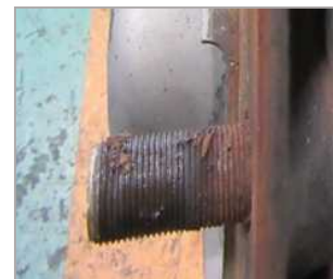
ボルトに著しいさびや汚れの付着
