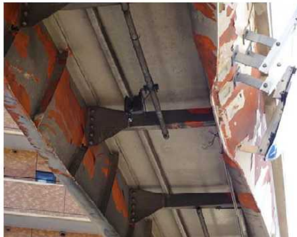
損傷状況 (下から見た様子)
